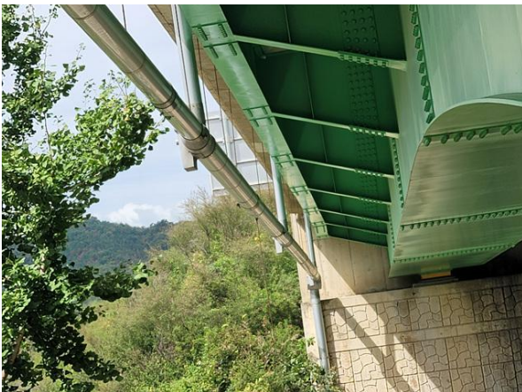
손상현황 • S1 배수관 지지대 탈락(1EA) 원 인 • 장기공용, 시공미흡 등 조치방안 • 정비
