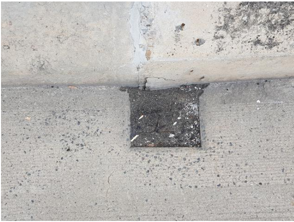
손상현황 • S2 배수구 막힘(1EA) 원 인 • 장기공용, 비산물퇴적 등 조치방안 • 정비
