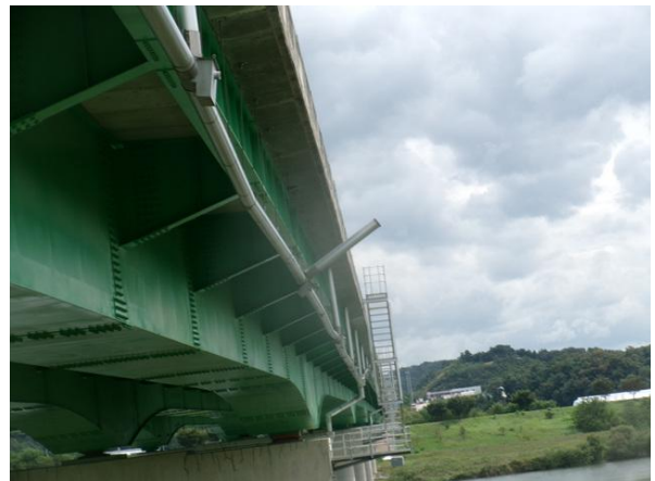
손상현황 • S4 배수관 탈락(1EA) 원 인 • 장기공용, 시공미흡 조치방안 • 정비
