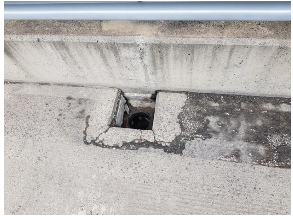
손상현황 • S3 배수구 그레이팅 망실(1EA) 원 인 • 시공미흡, 외부충격 등 조치방안 • 정비
